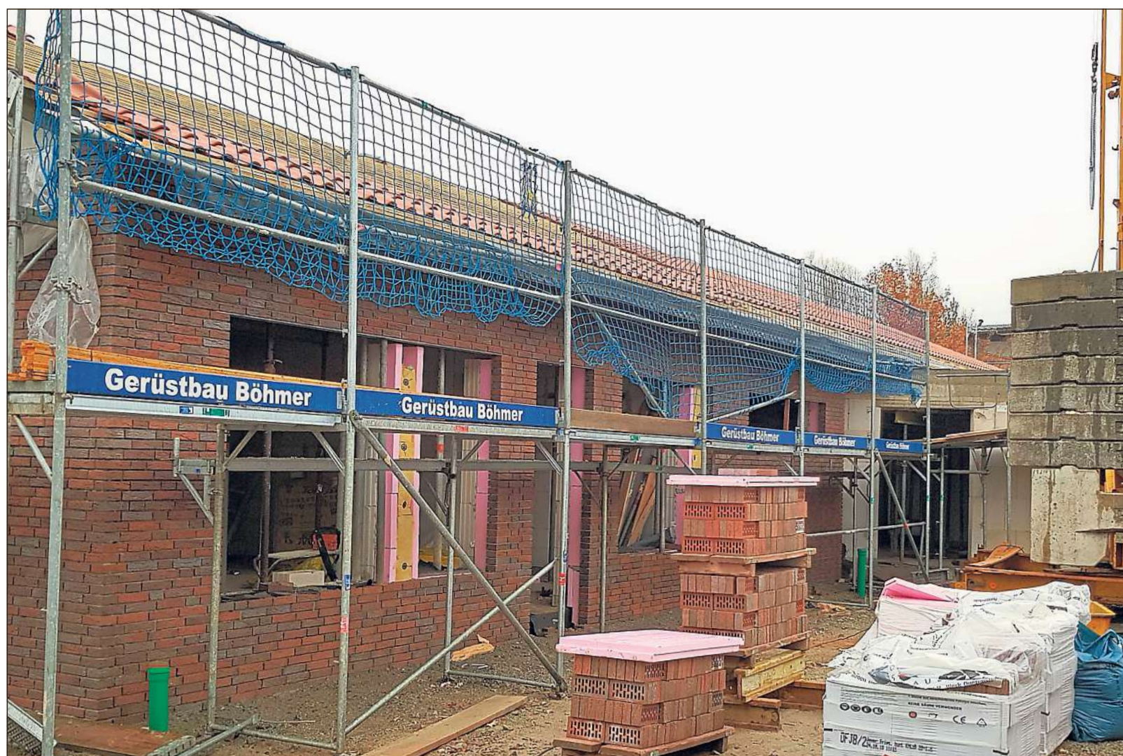
Nur noch die Fenster fehlen, dann ist der Neubau der Kita Himmelszelt an der Bussemasstraße in Marienburg dicht. Sie sollen in der ersten Januarwoche eingesetzt werden. Bild: Aundrup
